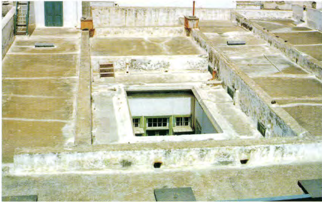
La cubierta de las viviendas son preparadas para acoger el agua potable de la lluvia. Azotea Casa Armas
