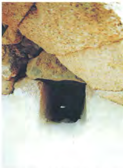
«Aliviadero» o «Rebosadero» en aljibe
